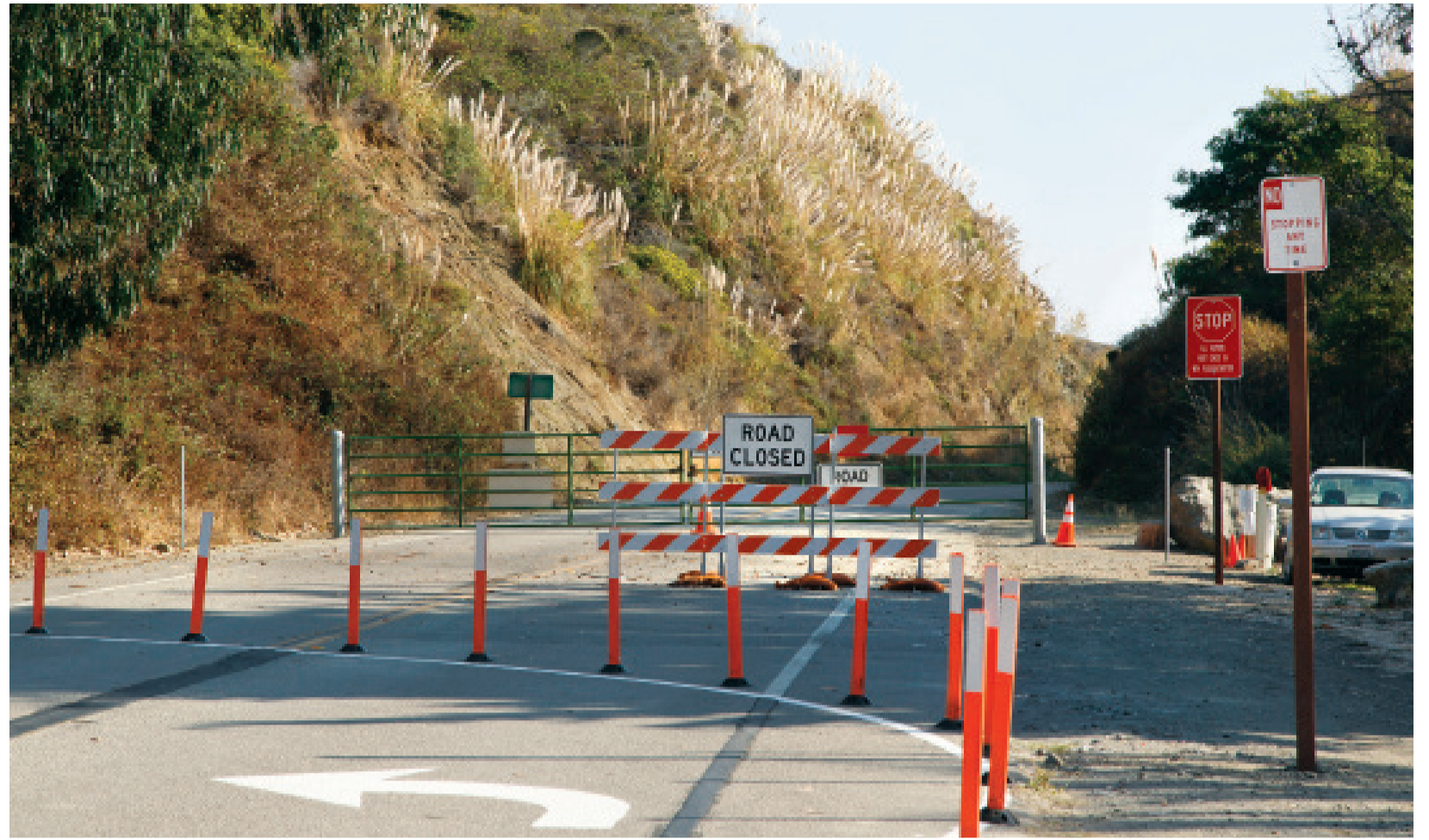
LA ROUTE EST COUPÉE À GORDA EN RAISON DU GLISSEMENT DE TERRAIN. ELLE NE ROUVRIRA PAS AVANT L'ÉTÉ 2018.
